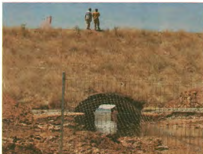
Fisura de la balsa de regulación de aguas del Júcar.
